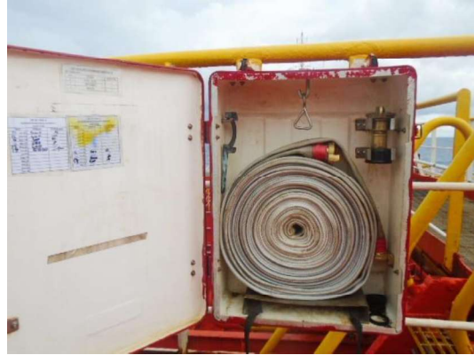
Gambar 2.11 : Fire Hose Station Sumber : Dokumen Pribadi (2024)
