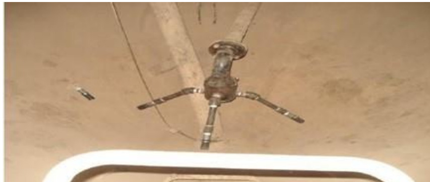
Gambar 2. 6 Komponen Didalam Tangki Dry Bulk (Barite) Sumber: Hadiid, A. P. (2016) Optimalisasi Kinerja System Bulk Compressor Pada Saat Bongkar Muatan Barite Ke Jack Up Rig Deep Drilling 8 Di Kapal AHTS MV.Trine K.
