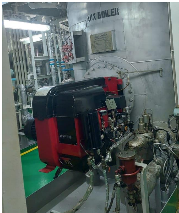
Gambar 4. 2 Boiler kapal VLGC Pertamina Gas 1 Sumber : Dokumentasi pribadi (2021)
