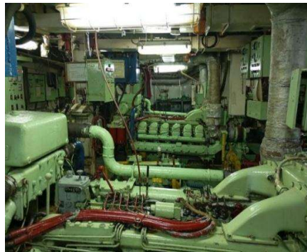
Gambar 3.3 Kondisi Ruang Mesin Sumber Dokumen Pribadi (2025)
