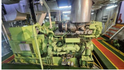
Gambar 2. 4 Auxiliary Engine Sumber : Dokumentasi Pribadi
