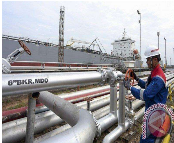
Gambar 2.14. Jalur pipa yang panjang menyebabkan residu minyak tersisa di sepanjang pipa Sumber : Dokumen Sendiri
