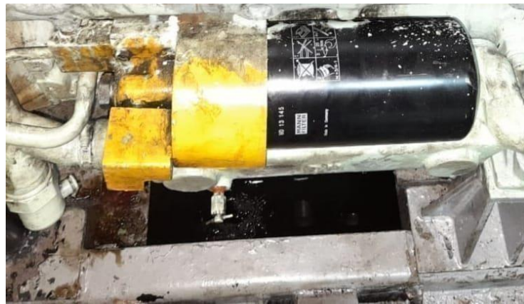
Gambar 2.6 Filter oli generator
