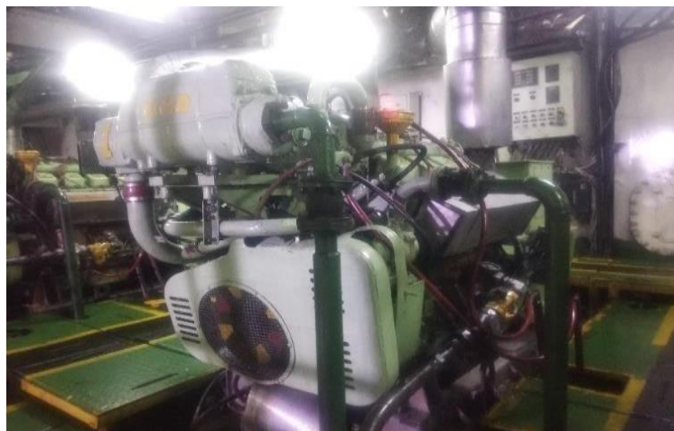
Gambar 2.2 Generator Sumber : Data Pribadi
