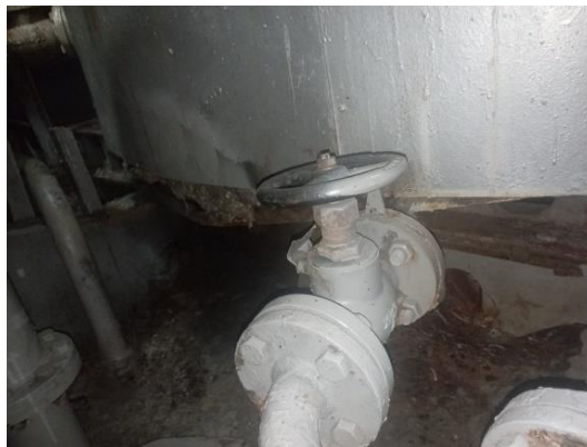
Gambar 2. 19 Blow Down Valve Sumber : Dokumentasi pribadi (2023)
