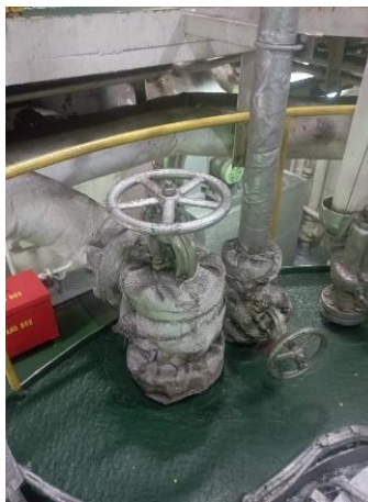
Gambar 2. 11 Main Steam Valve Sumber : Dokumentasi Pribadi (2023)
