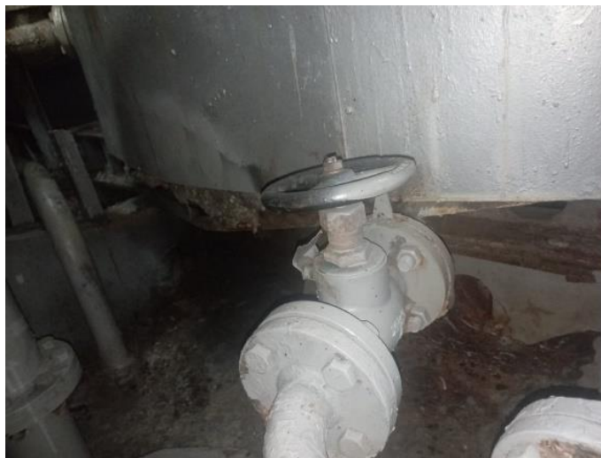
Gambar 2. 10 Blow Down Valve Sumber : Dokumentasi pribadi (2023)
