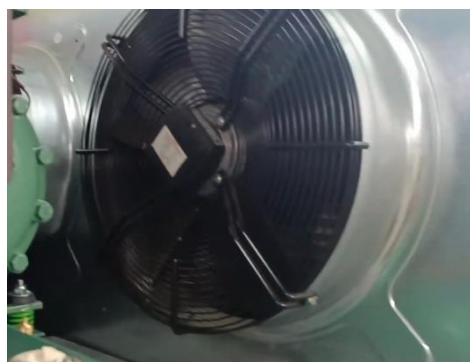
Gambar 2. 4 Kondensor Sumber : Dokumen Penulis (2022)
