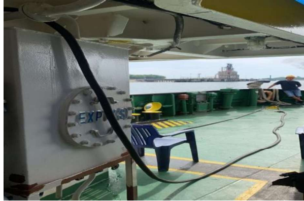
Gambar 2. 17 Tangki Ekspansi Sumber: Km. ASD.TRANSKO SIKATAN
