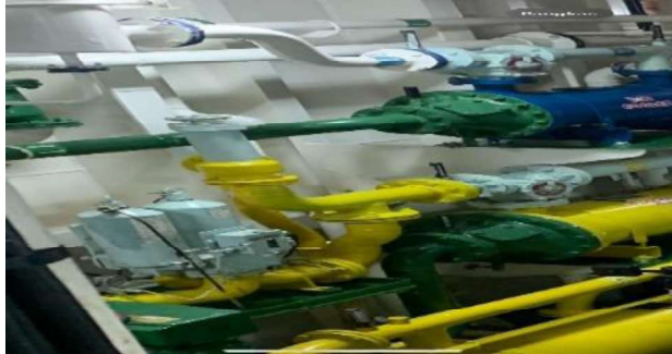
Gambar 2. 16 Pipa Pendingin Mesin Induk Sumber: Km. ASD.TRANSKO SIKATAN
