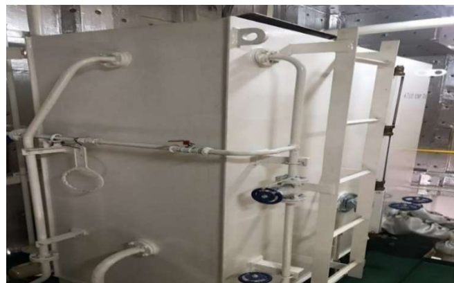
Gambar 2. 2 Expansion Tank Sumber: Dokumen Pribadi
