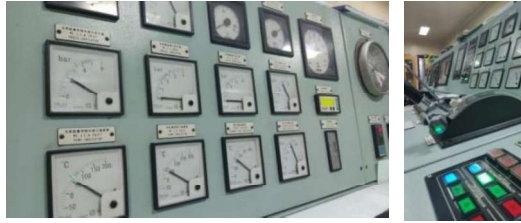
Gambar 2. 6 Engine Control Room . Sumber : Dokumentasi pribadi.
