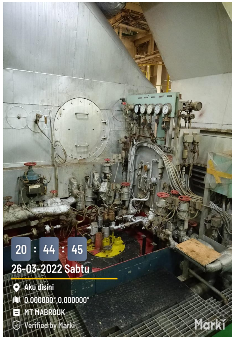
Gambar 2.1 Boiler Sumber: Dokumen Pribadi (2022)
