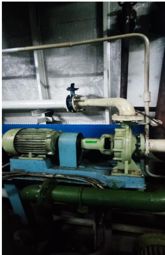
Gambar 2.4 Pompa Pendingin Air Tawar Sumber : Dokumentasi pribadi (2022)
