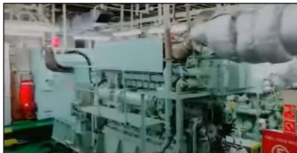
Gambar 2.1 Kamar Mesin Kapal Sumber: Dokumen Pribadi (2024)
