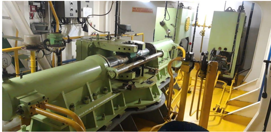
Gambar 2. 2 Mesin kemudi elektrik hidrolis
